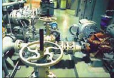
Zonas de fugas o derrames de fluidos
